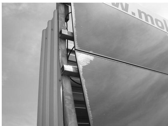
Obr. 3. Příčinou snížené životnosti byla ztráta integrity zatekáním srážkové vody pod krycí sklo
