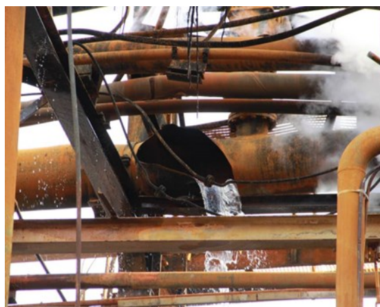
Obr. 5. Roztržené potrubí propylenu DN 500
